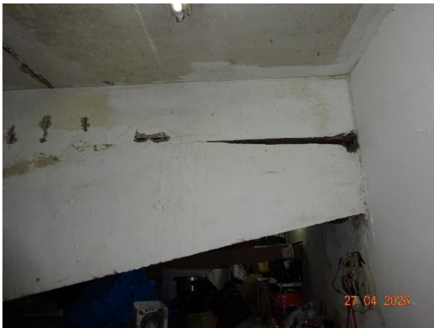
Figura 4 - Face inferior de elemento estrutural com deterioração localizada.
