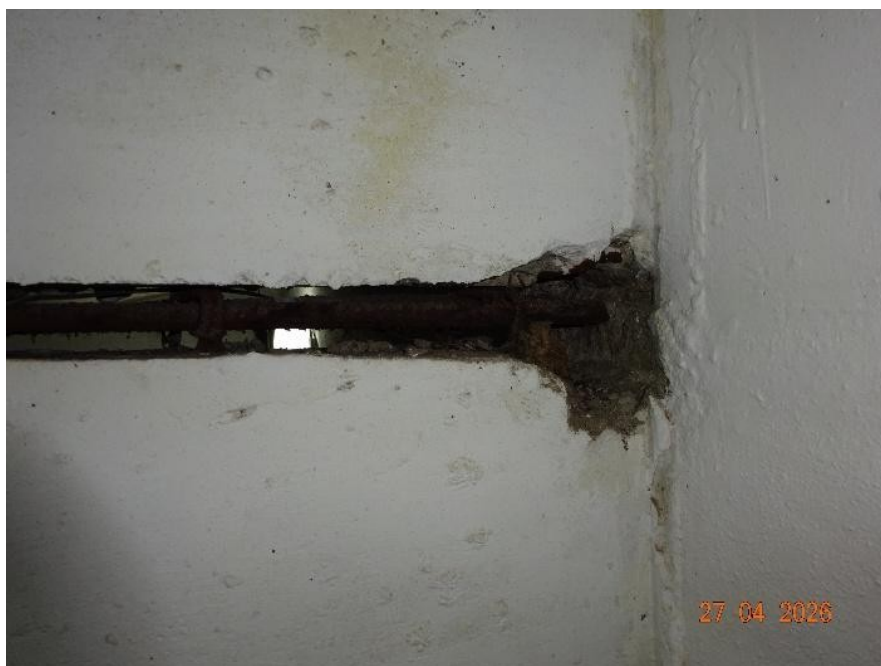
Figura 3 - Região com fissuração/desplacamento a ser delimitada em inspeção próxima.
