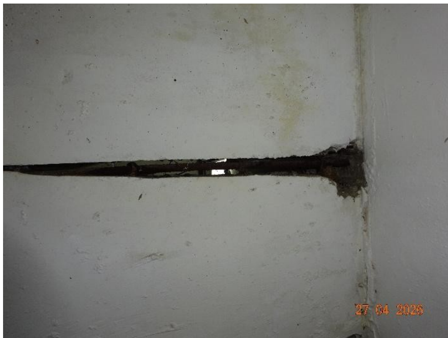
Figura 2 - Perda localizada de cobrimento associada à deterioração do concreto.
