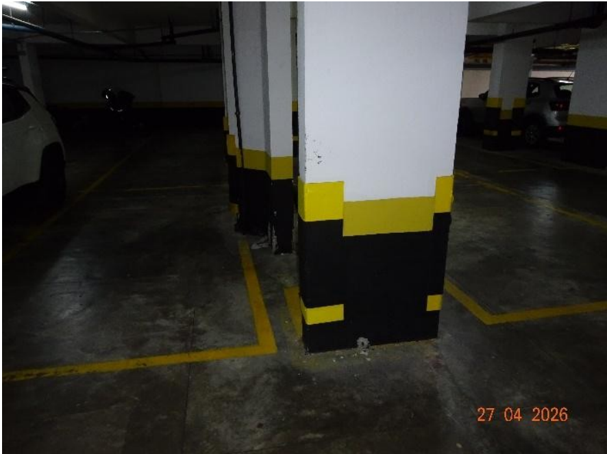
Figura 1 - Manifestação em concreto armado com armadura exposta e sinais de oxidação.
