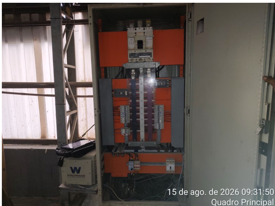
Figura 6 - Painel de processo - condutores fora de canaletas e organização deficiente.
