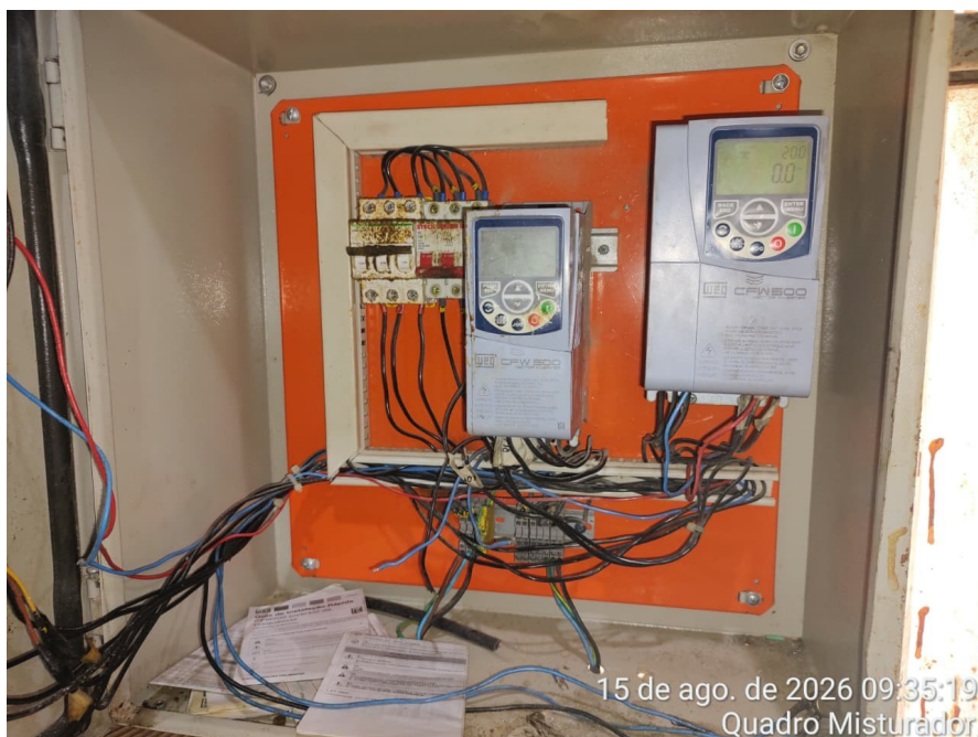
Figura 5 - QGBT - arranjo interno e derivações.
