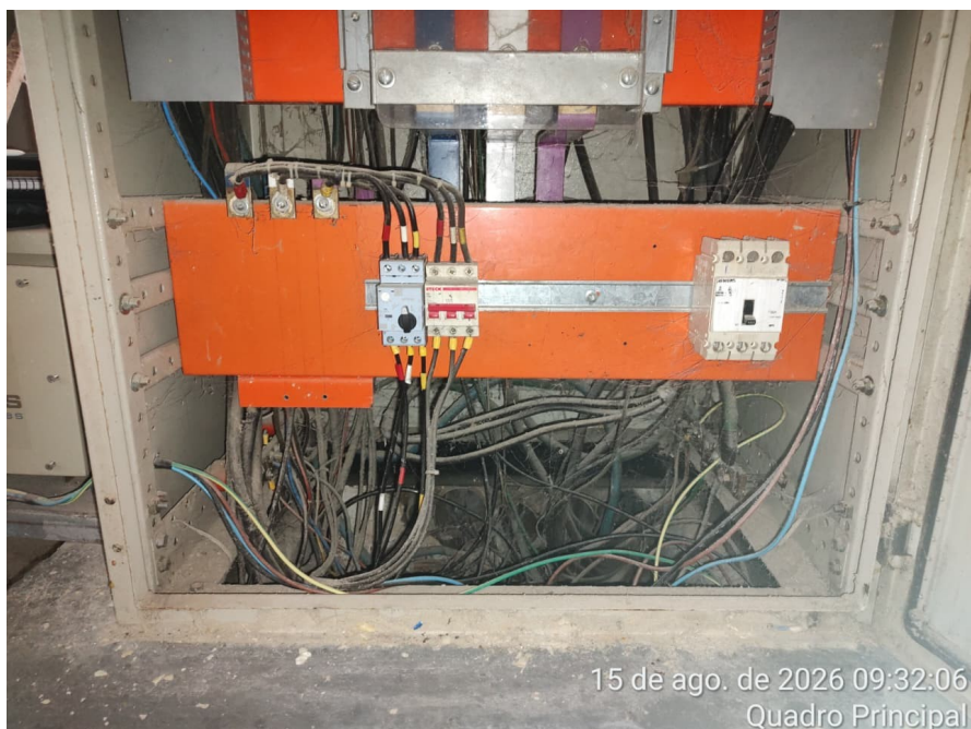
Figura 4 - Quadro com sinais de corrosão, sujeira e passagens abertas.
