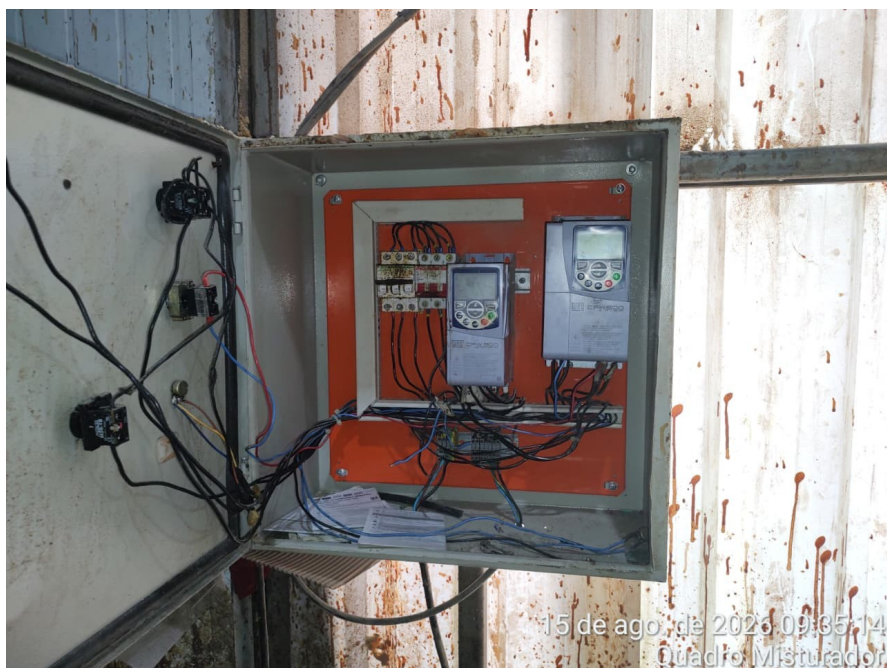
Figura 3 - Barramentos e dispositivos de potência - proteção contra contato a verificar.
