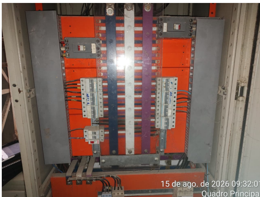
Figura 2 - Painel com inversores - verificar proteção, identificação e fechamento.
